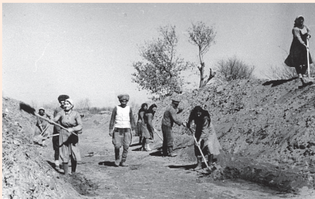
Работы по реконструкции канала им. Октябрьской революции в 1944 г. © Центральный государственный архив РД. Махачкала, 2020
